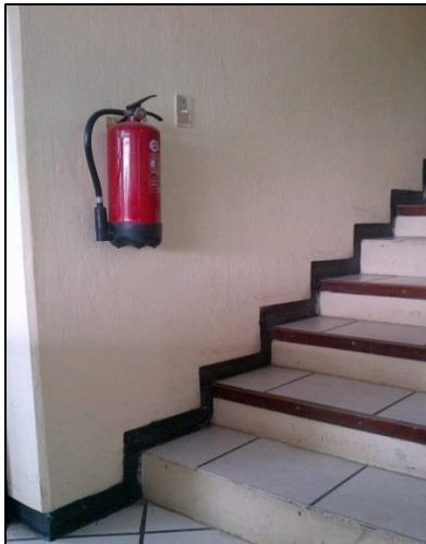
Figura 8. Extintor de fuego portátil a base de CO 2 ubicado en cada piso del edificio
