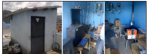
Figura 6. Parte del equipamiento del Data Center en la bodega del Edificio Municipal
