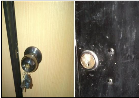
Figura 7. Cerraduras manuales en las puertas del CPD (izquierda: oficina, derecha: bodega)
