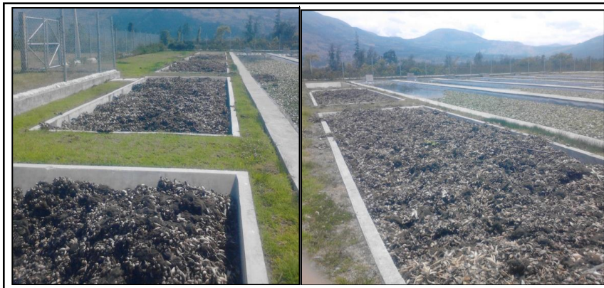
Figura 4. 7 Lechos de Secado Fuente: Autor
