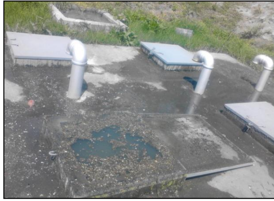
Figura 4. 3 Tanque Sedimentador Fuente: Autor
