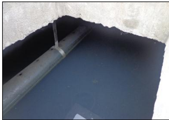
Figura 4. 5 Filtro de Flujo Ascendente Fuente: Autor
