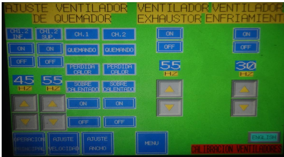
Gráfico N° 40 Panel De Calibración De Ventiladores
