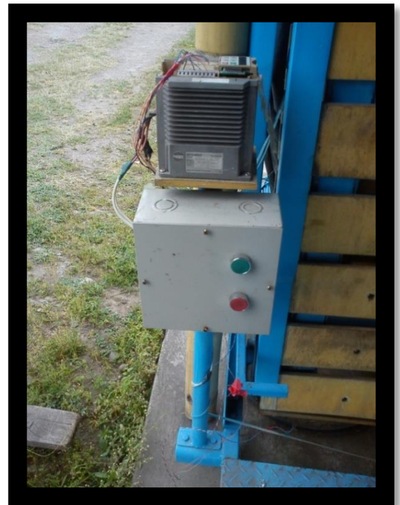
Figura 4.1 Montaje del variador de Velocidad y botones de encendido y apagado
