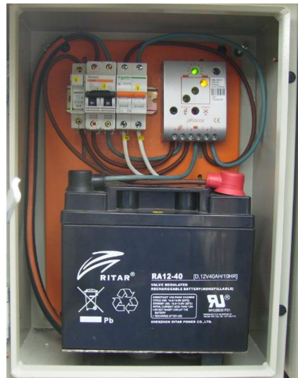
Figura 2 Gabinete de almacenamiento y distribución
