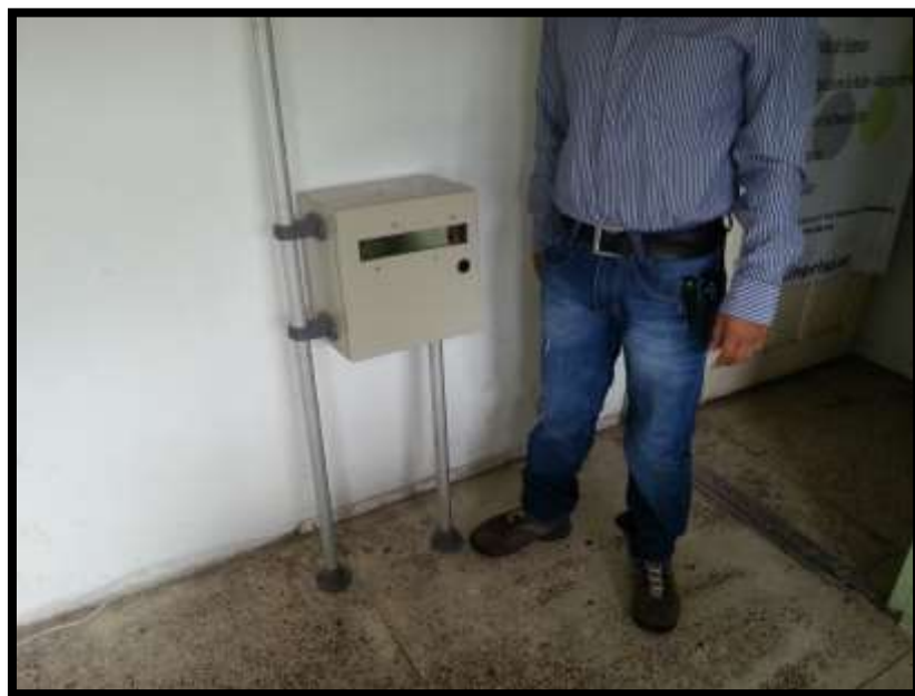
Figura. 44 Pruebas de funcionamiento del contador
