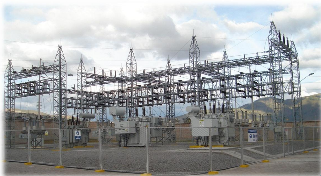
Gráfico N° 1 Subestación Alpachaca patio de 69 kV
