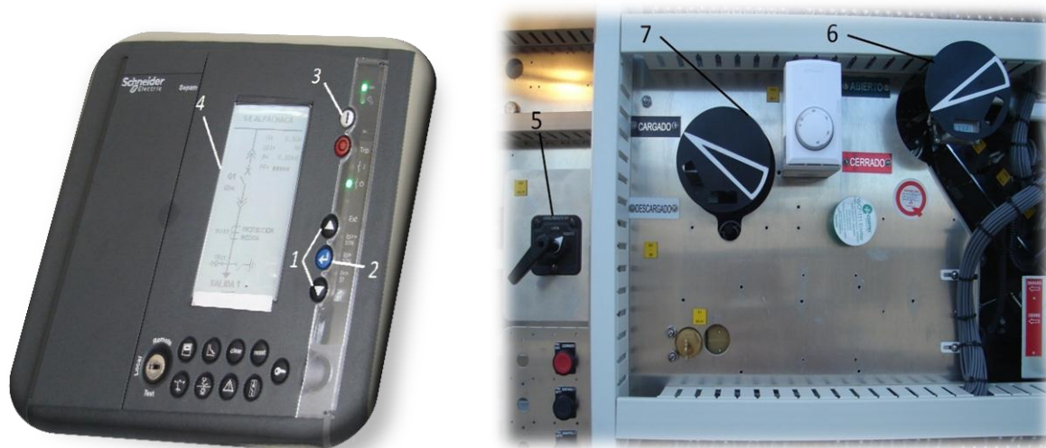
Gráfico N° 21 Relé sepam S82 e interruptor en remoto y cerrado
