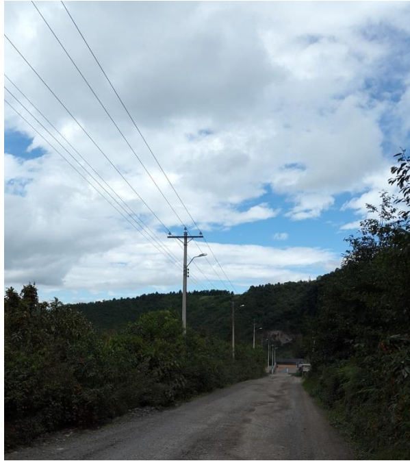
Figura 116. Postería al Sector de Apuela.
