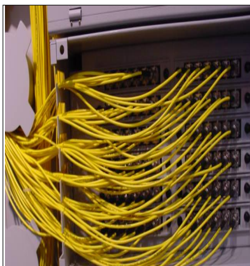
Figura 59. Orden de cable de fibra óptica
