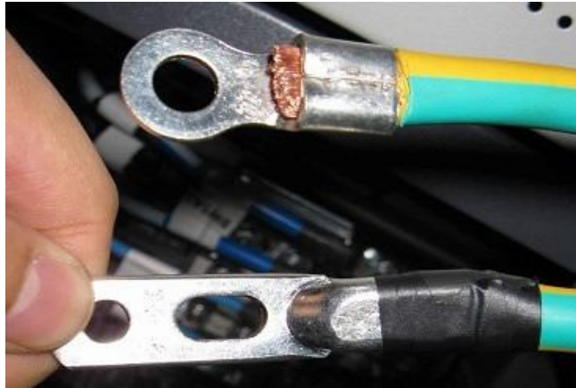
Figura 53. Aterramiento de racks
