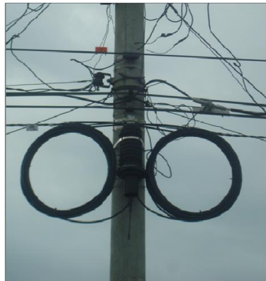
Figura 123. Reserva de Cable de Fibra óptica con Manga de Empalme
