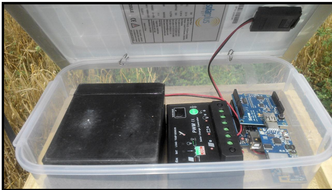
Figura 54. Componentes de un nodo sensor debidamente conectados.
