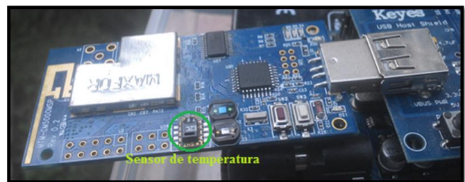
Fig.29 Identificación del sensor de temperatura en un nodo sensor instalado
