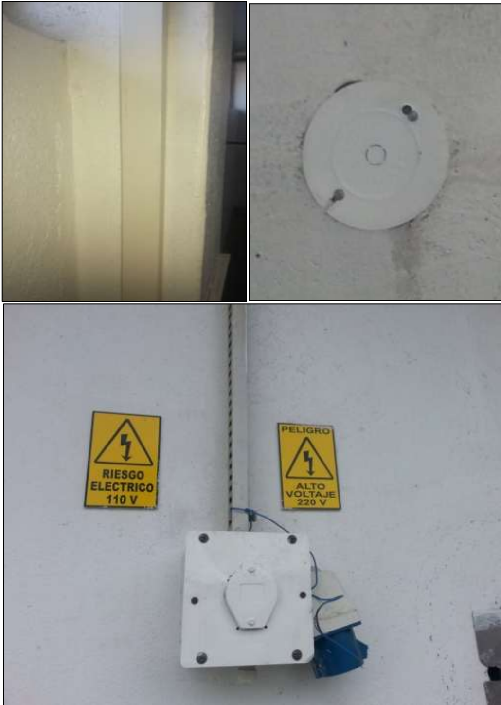
FIGURA 6.15: Instalaciones eléctricas después de la implementación
