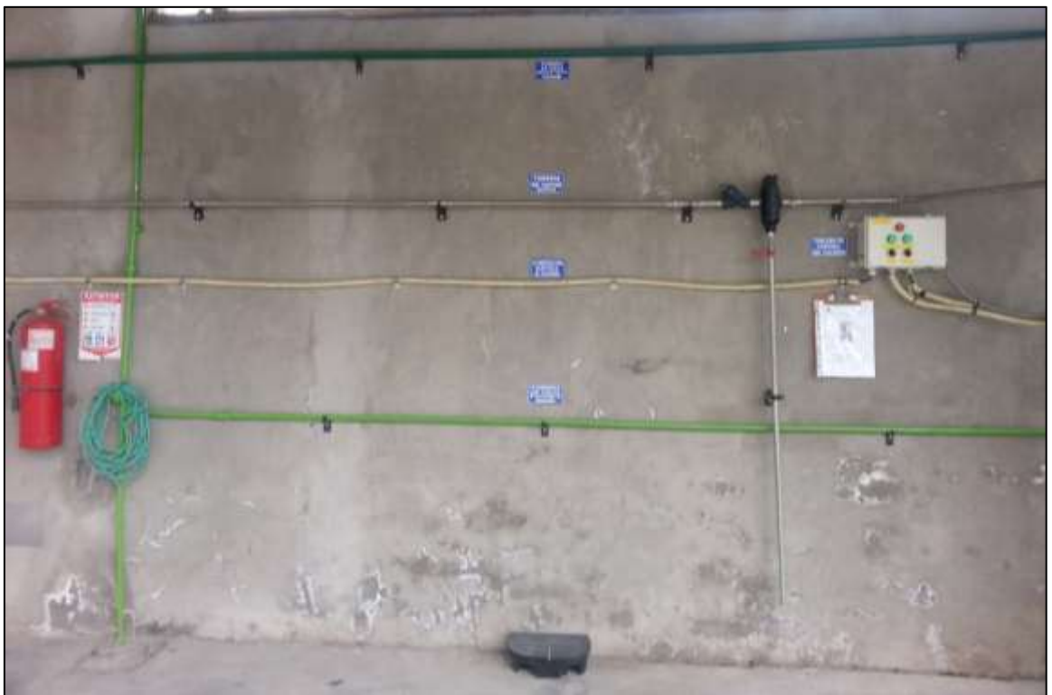
FIGURA 6.17: Tuberías de fluidos después de la implementación
