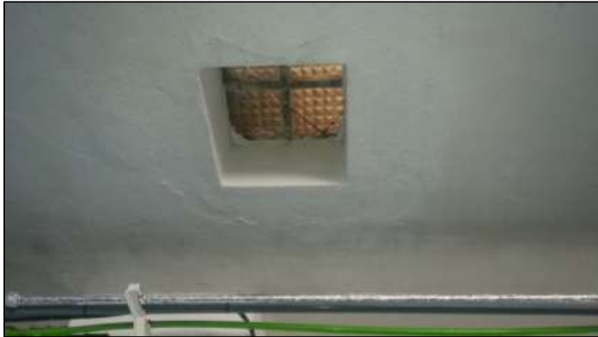
FIGURA 6.10: El techo antes de cubrir las ventanillas que tenia
