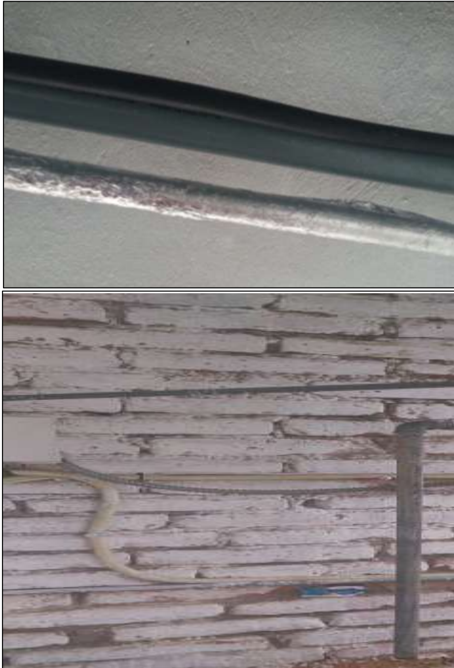
FIGURA 6.16: Tuberías de fluidos antes de la implementación
