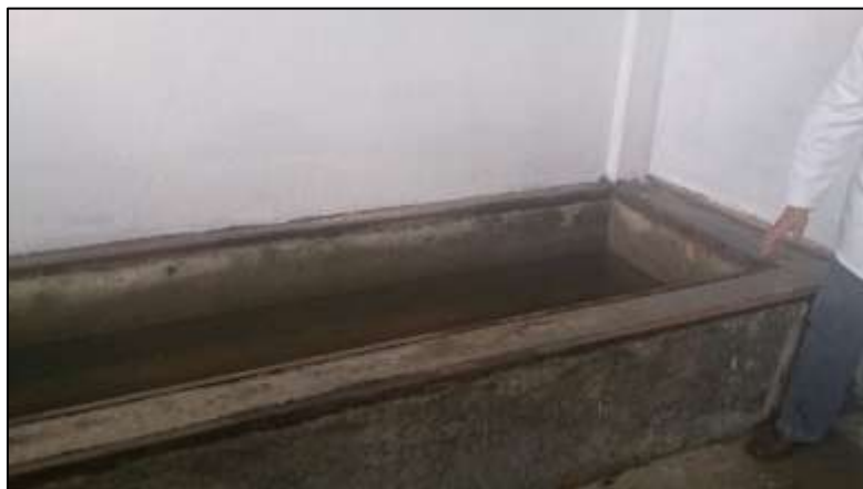
FIGURA 6.12: Tanque de almacenamiento de agua reciclada
