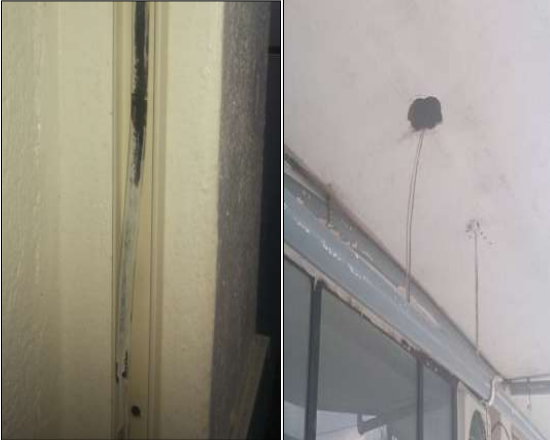
FIGURA 6.14: Instalaciones eléctricas antes de la implementación
