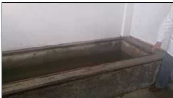
Figura 15. Tanque de almacenamiento de agua reciclada
