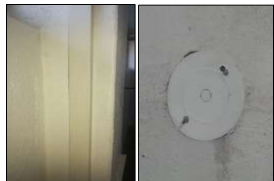
Figura 18. Instalaciones eléctricas después de la implementación
