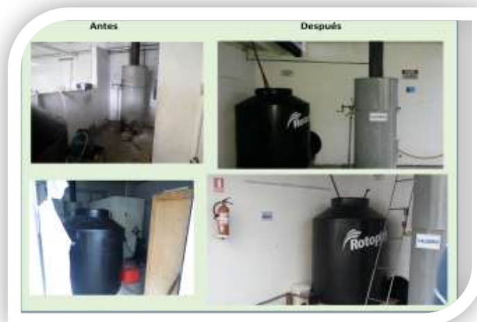
FIGURA 6-10: Caldero, Tanque de suero y equipo de extinción de fuego de
