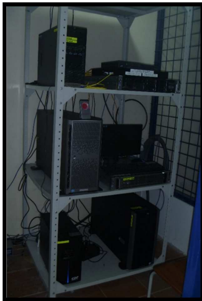
Figura 10. Rack 2 de comunicaciones Referencia: Departamento de sistemas de FLORALP.
