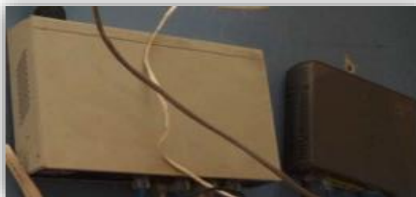
Figura 42: Equipos de distribución
