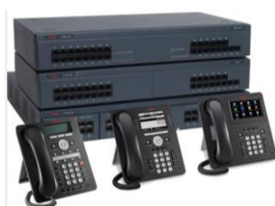
Figura 81. Central Telefónica Ip Office 400.
