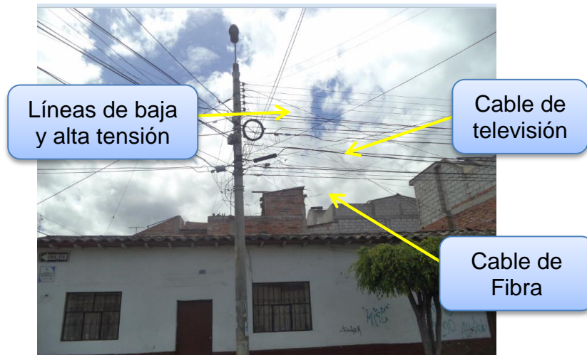
Figura 69. Tendido de las diferentes redes en los postes. Fuente: Calles Fernando Villamar y José Joaquín de Olmedo.
