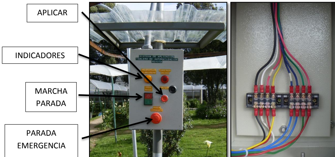
Figura 96: Tablero automatización – remoto Fuente: Autor
