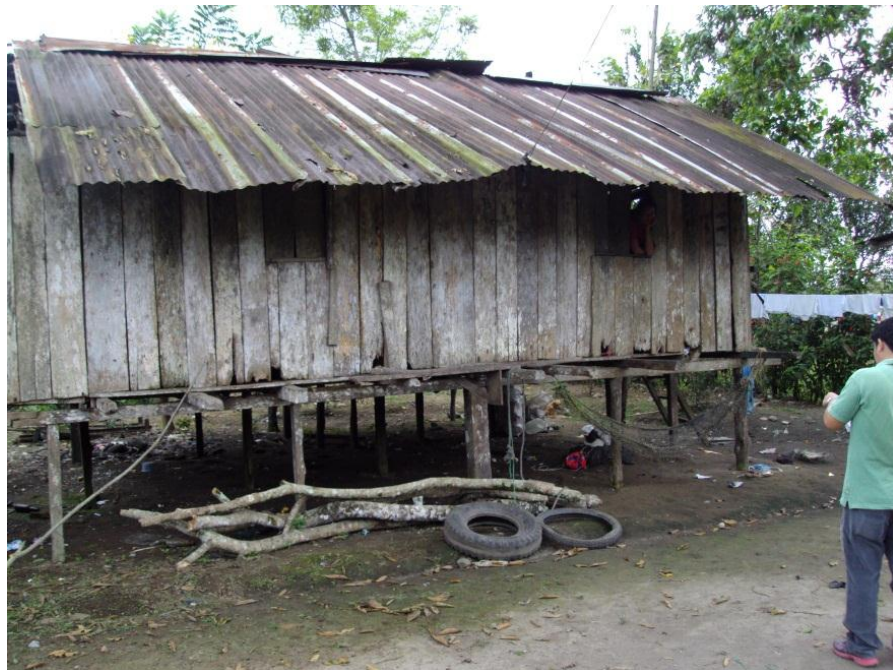
Techo, paredes destruidas
