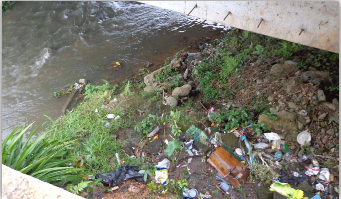
Lugar en mal estado.
