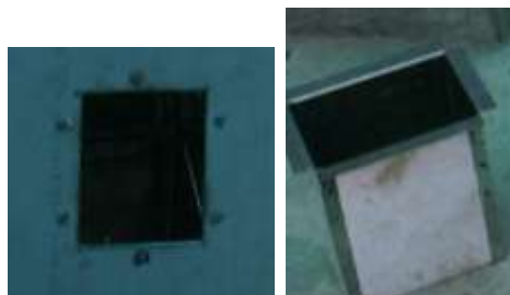
Figura 3. 37 Instalación del sistema de racionamiento
