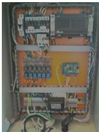
FIGURA 3.2 Tablero de control terminado
