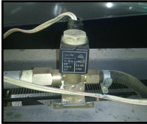
Figura 75. Electroválvula instalada Fuente: Autor
