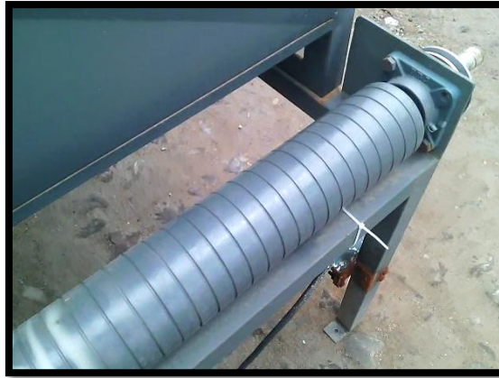
Figura 62. Instalación sobre chumacera de pared Fuente: Autor
