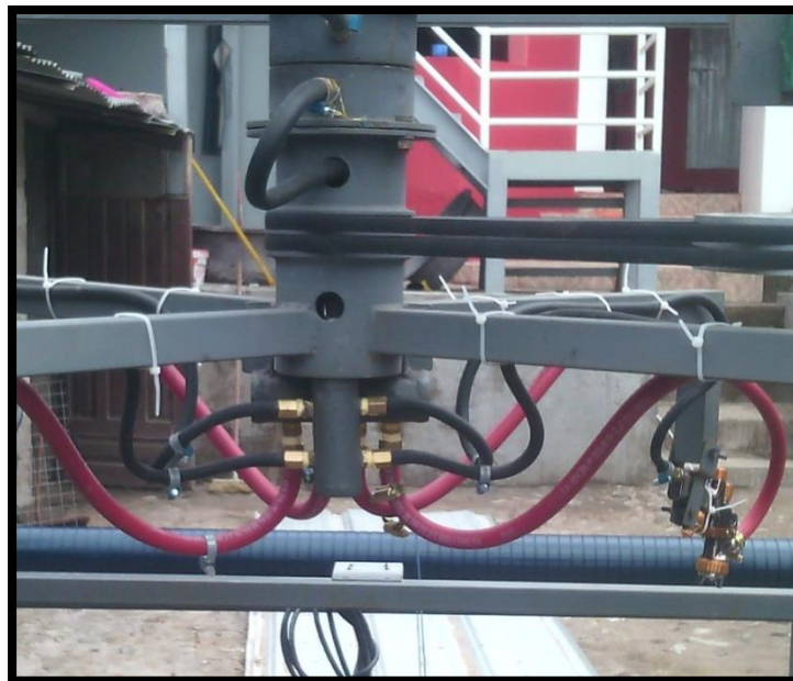
Figura 77. Tubería de pintura (color rojo)
