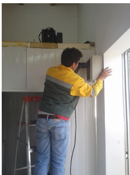
Figura 4.11 – Instalación de sistema de control Elaborado: Guillermo Pacheco
