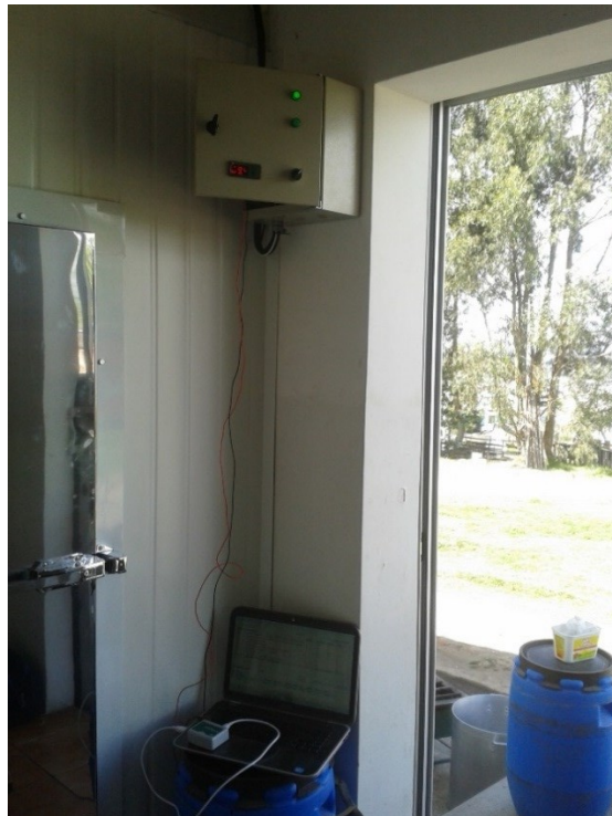
Figura 4.13 – Prueba de equipo
