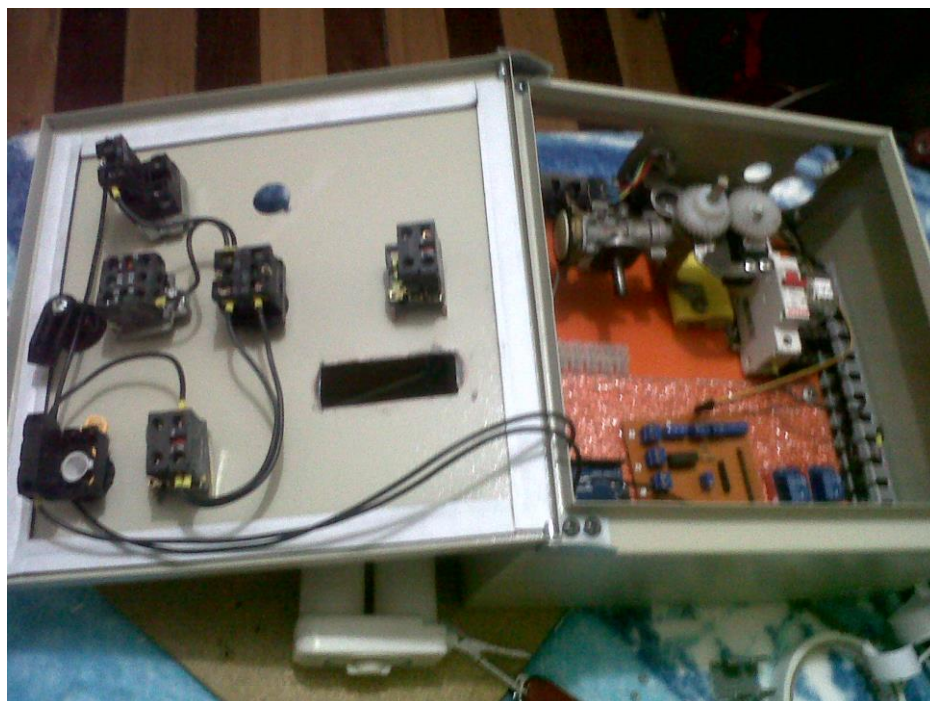
Figura 5.14 Armada del tablero de control con botones
