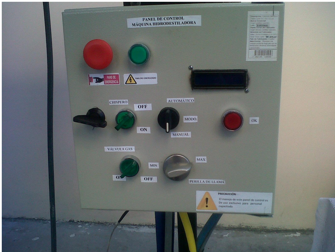
Figura 4.18 Tablero de control vista de frente
