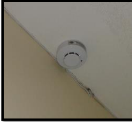
Figura 41. Detector de incendios
