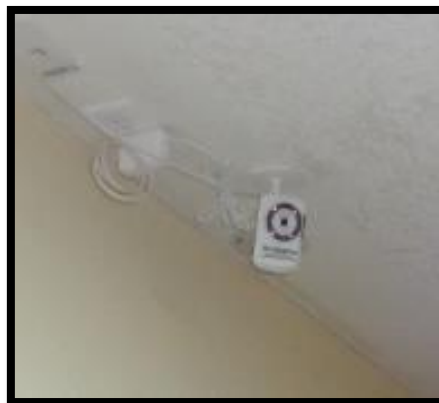
Figura 42. Cámara de vigilancia Fuente: Instalaciones de la Cooperativa Cuarto de Equipos
