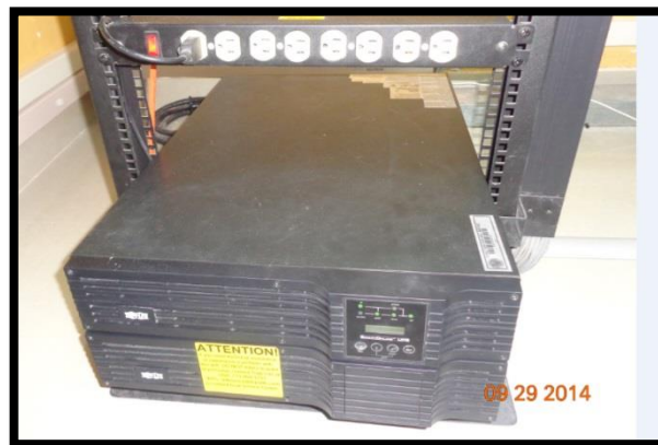
Figura 40. Red UPS del cuarto de equipos
