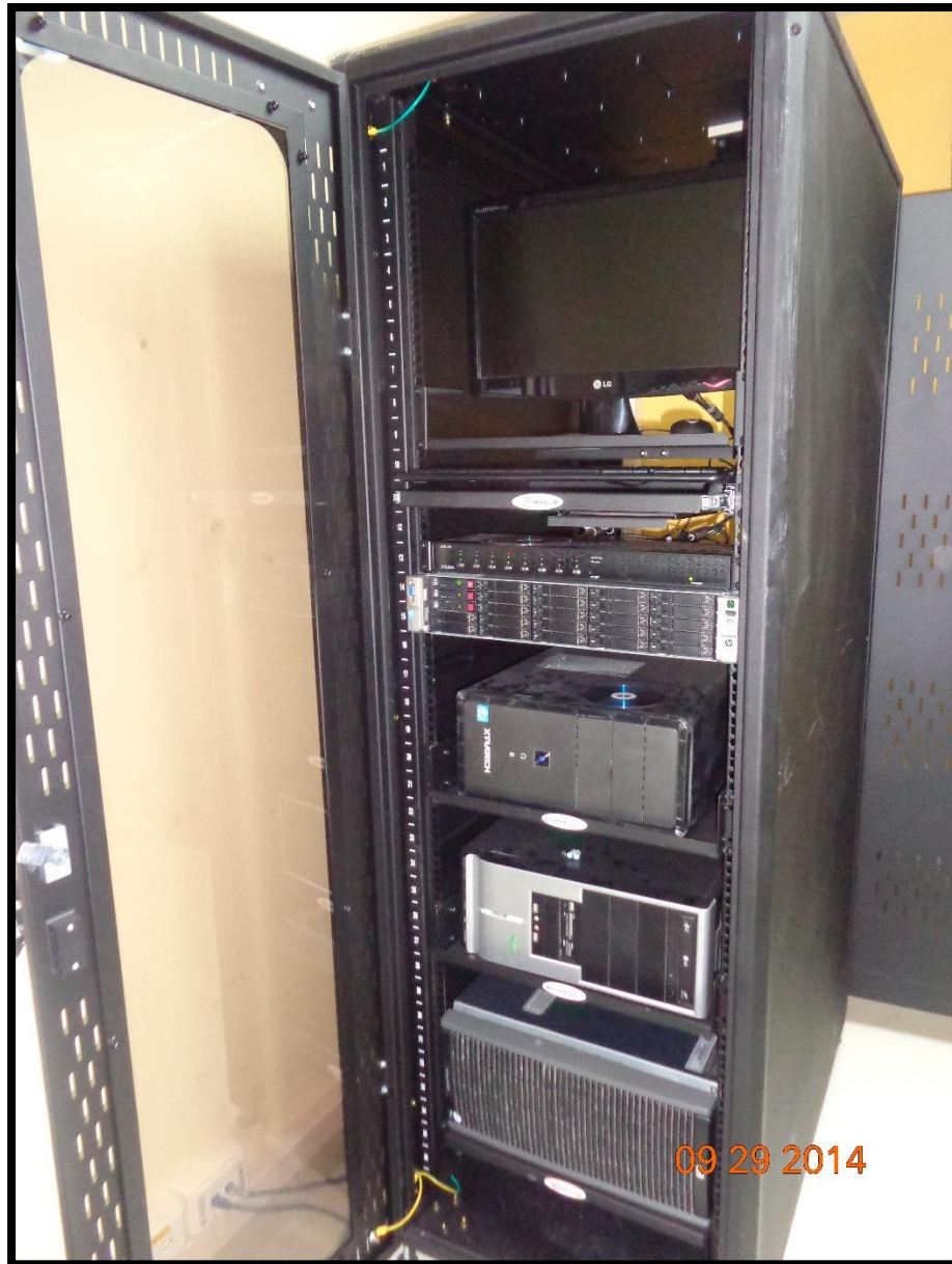
Figura 37. Rack de los servidores Fuente: Instalaciones de la Cooperativa Cuarto de Equipos
