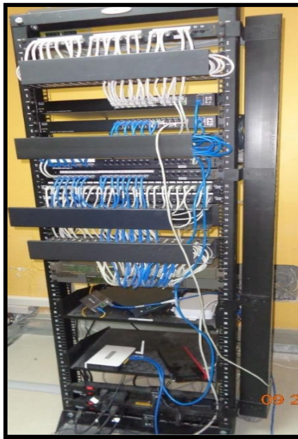
Figura 35. Rack con equipos de red Fuente: Instalaciones de la Cooperativa Cuarto de Equipos
