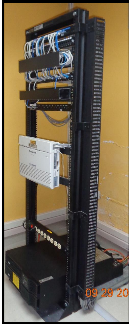
Figura 36. Rack central de voz Fuente: Instalaciones de la Cooperativa Cuarto de Equipos
