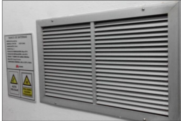
Figura 14. Sistema de Aire acondicionado
