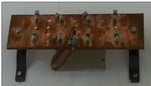
Figura 13. Barras de puesta a tierra
