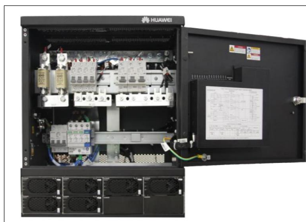
Figura 12. Equipo rectificador TP48300B
