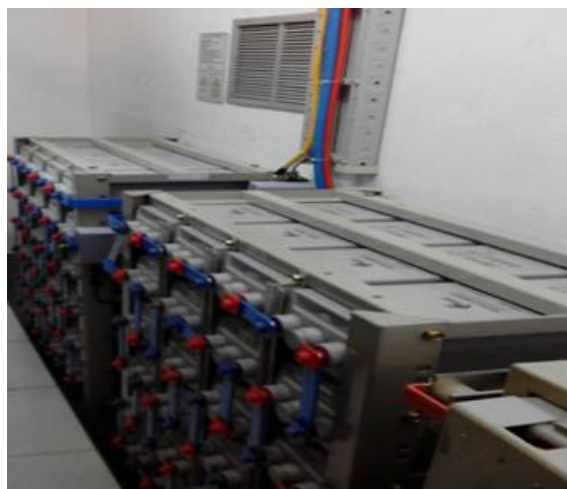
Figura 11. Sistema de Baterías
