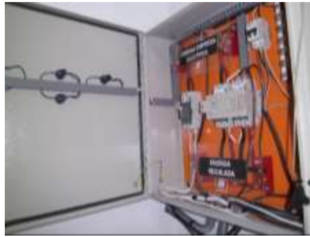
Figura 13. Tablero de distribución de energía.
