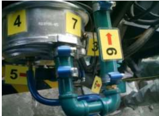
Figura 20. Vista superior de la instalación del vaporizador Fuente. (Autores, 2014)
