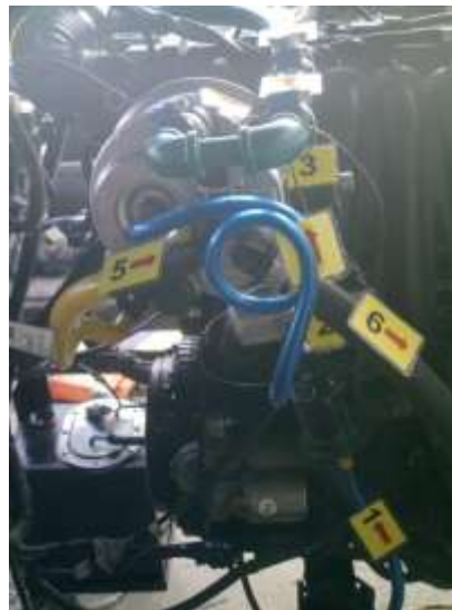
Figura 21. Vista frontal de la instalación del vaporizador Fuente. (Autores, 2014)
