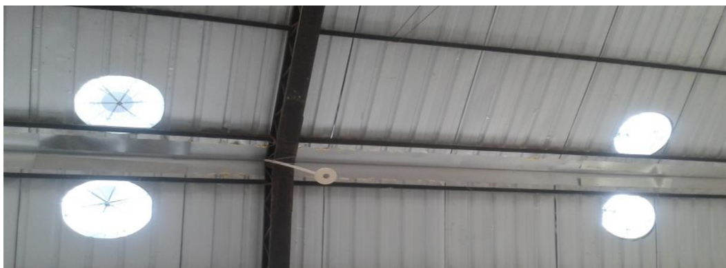
Figura 16. Vista interna superior de los extractores.
