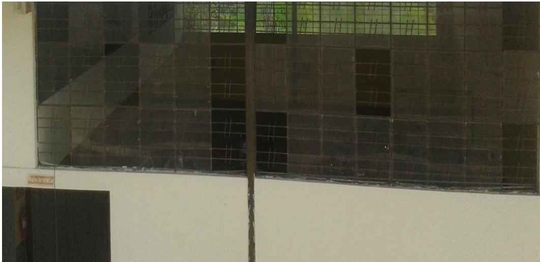
Figura 10. Estado de las ventanas.
