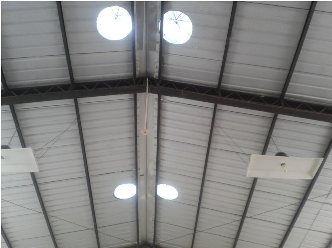
Figura 23. Vista superior interna del taller después de haber colocado los extractores eólicos.
