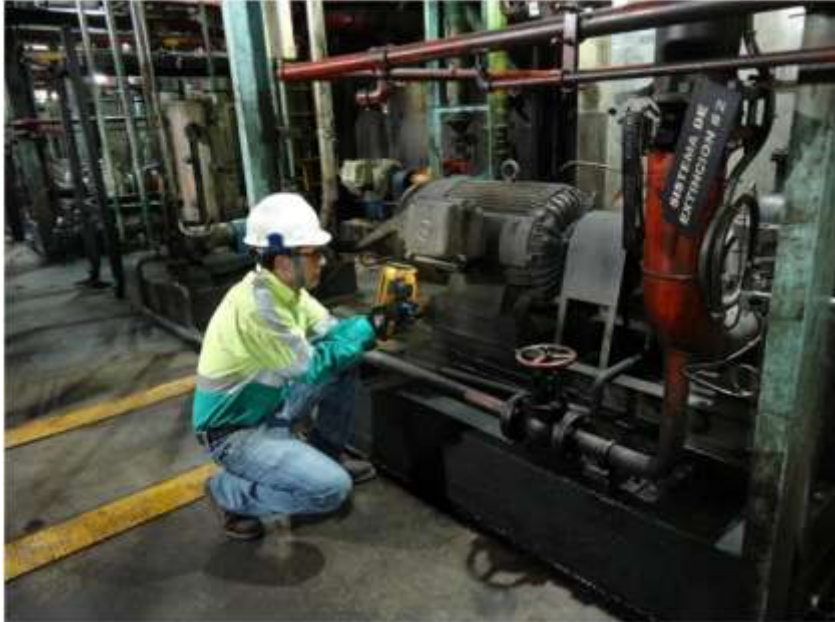
Toma de imagen termográfica a motor-bomba de lubricación principal MOTOR OTV-818-OE03
