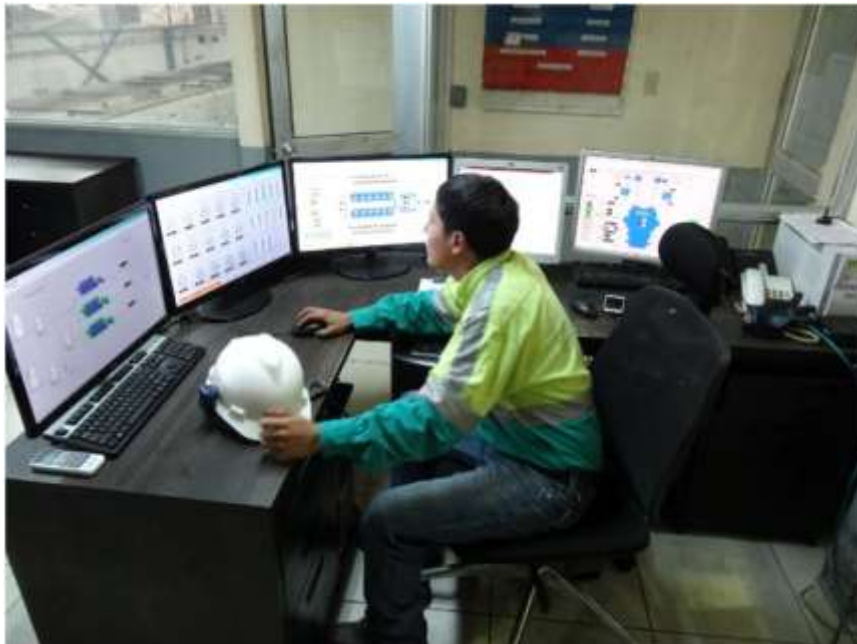
Sala de control grupos electrógenos UNACEM cementos.
