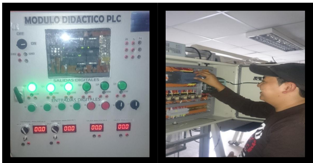
Figura. 4.19 Prueba de funcionamiento
