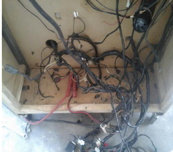
Cableado del sistema.
