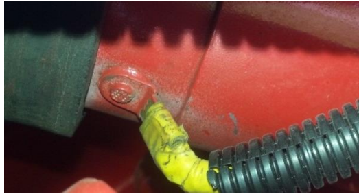
Figura 100. Terminal de precalentamiento
