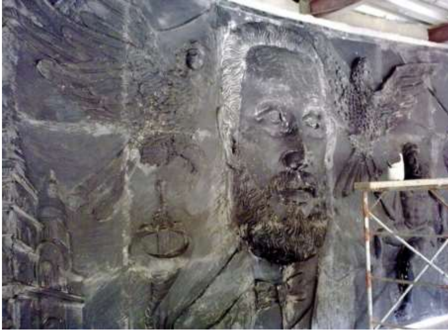
Fotografía N°- 16: Ensamblaje de las piezas en el lugar de la instalación del mural (2)
