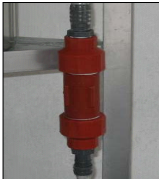
Fotografía 9. Filtro de carbón activado granular (GAC)
