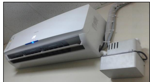
Figura 22. Sistema de Aire Acondicionado instalado Fuente: Proyecto de Diseño del Centro de Datos FICA
