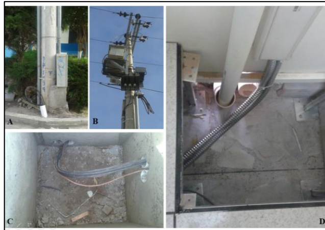
Figura 17. Acometida Eléctrica del CDP Fuente: Proyecto de Diseño del Centro de Datos FICA
