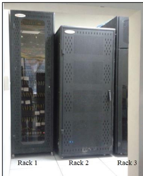
Figura 23. Racks instalados en el Data Center
