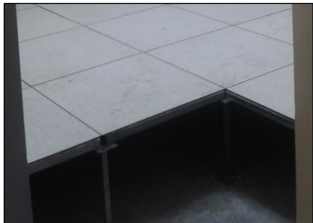
Figura 18. Piso Técnico instalado Fuente: Proyecto de Diseño del Centro de Datos FICA
