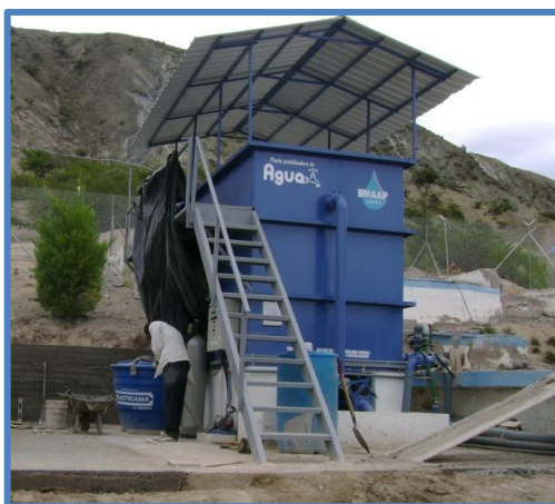
Planta de tratamiento de agua de Ambuquí
