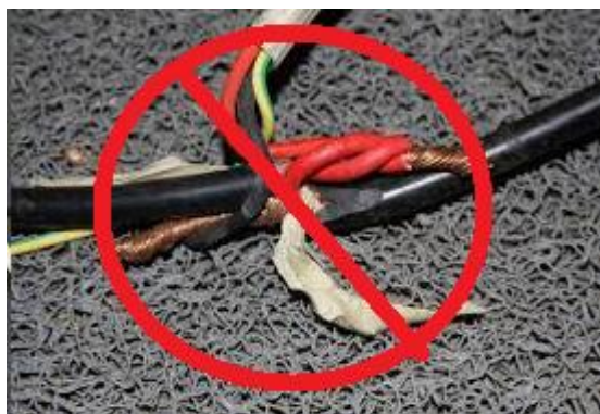
Figura 5. 4 Cables en mal estado
