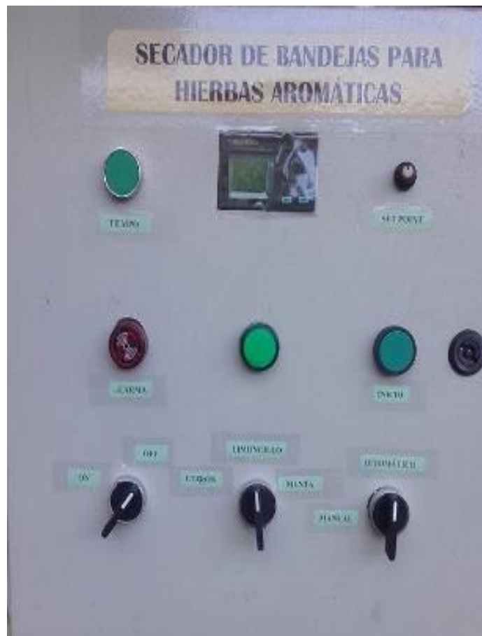
Figura 4. 17 Panel de control del sistema
