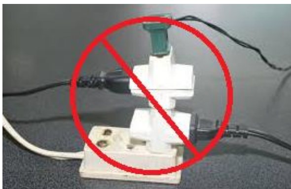
Figura 5. 2 Conexión en mal estado
