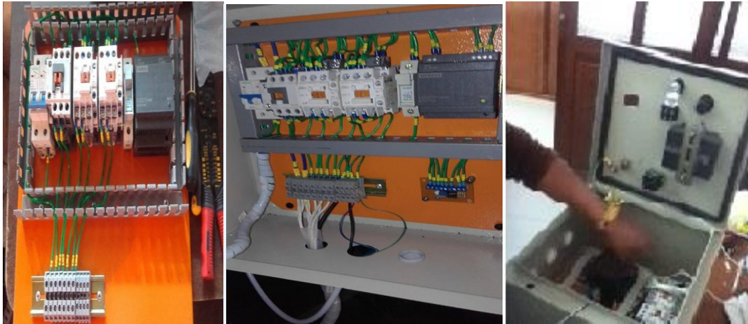
Figura 4. 16 Implementación del tablero de control
