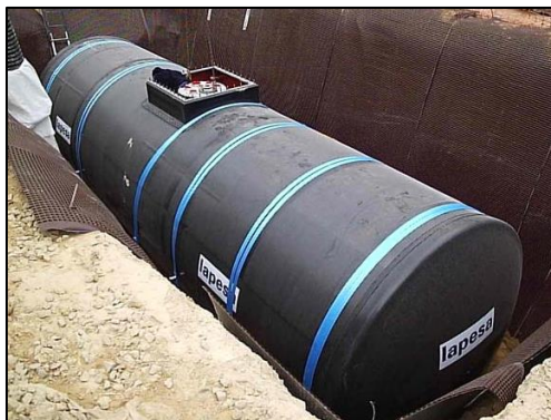
Figura 1. Depósito de combustible subterráneo Fuente: (Urbina, 2014)
