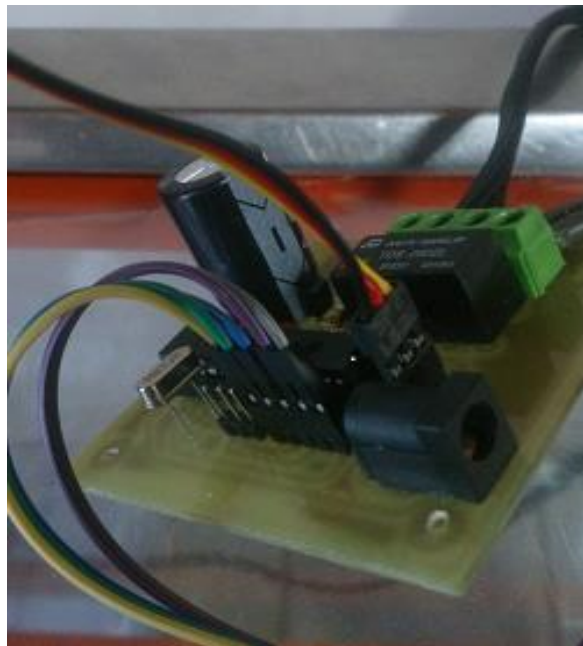
Figura N° 44 Circuito electrónico de flujo de agua conectado todos los elementos
