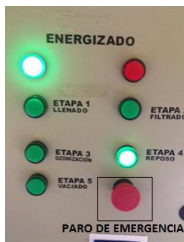
Figura 4.26: Paro de emergencia del panel de control del sistema
