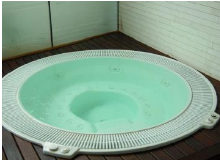
Figura 1.3: Hidromasaje con recirculación de uso colectivo
