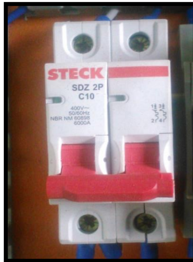
FIGURA 2.51 Breaker para la protección de la máquina
