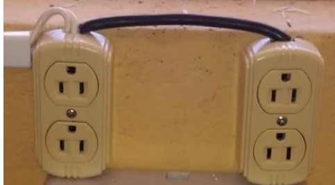
Figura 36. Instalación de la fuente de alimentación para los dispositivos electrónicos Fuente: Autoría
