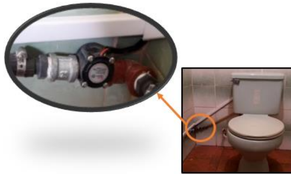
Figura 43. Ubicación del sensor de flujo de agua Fuente: Autoría
