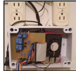
Figura 24. Instalacion de la placa Raspberry Pi 3 con su ventilador Fuente: Autoría
