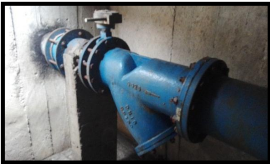
Figura 17. Tubería principal de agua potable de la calle Juana Atabalipa
