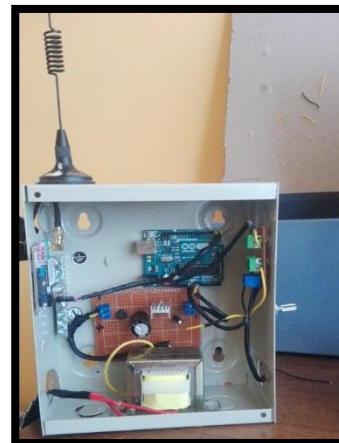
Figura 12. Tablero industrial #2 sistema de transmisión
