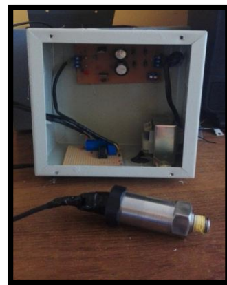
Figura 13. Tablero industrial #3 sistema de transformación de corriente a voltaje
