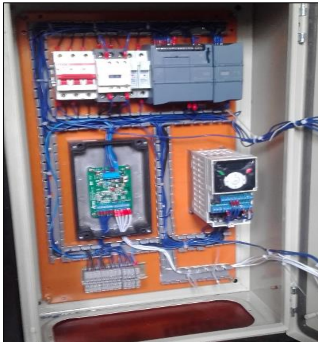
FIGURA 4. 24: Cableado parte interna de tablero
