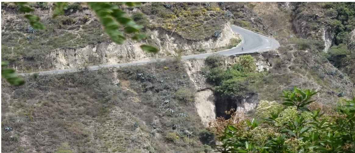
P22 Deslizamiento en la vía a Cahuasquí
