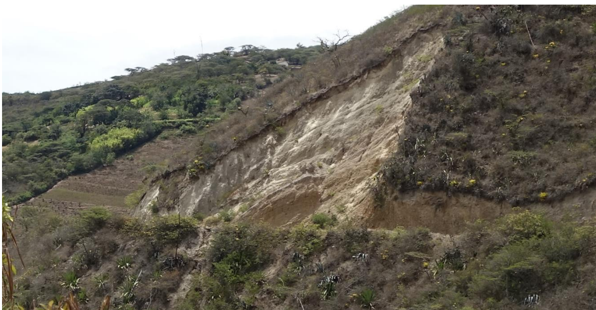
P24 Deslizamientos en la vía
