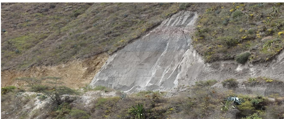
P23 Deslizamientos en la vía
