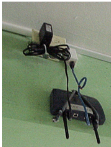
Figura 5.4: Posición del Access Point
