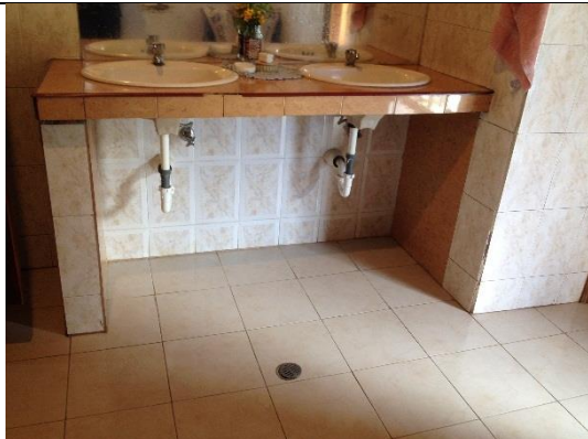
AF 21.- Lavamanos baño 1
